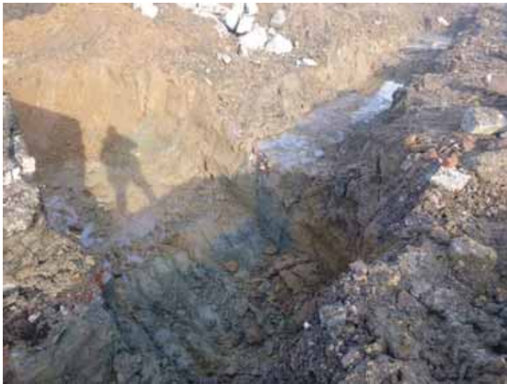
6 La zone du caniveau après retrait des produits, de la structure en brique et des terrains encaissants contaminés.
